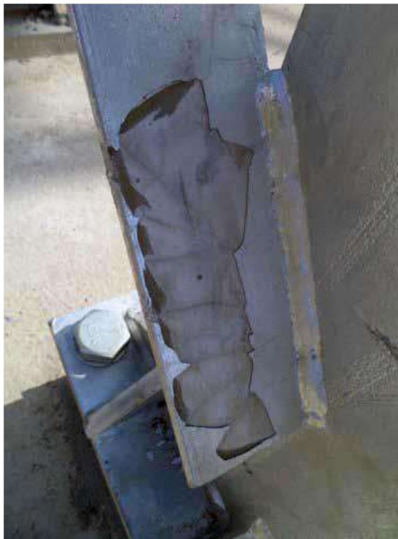
Fotos 2 - 5: Niveles de fósforo fuera de rango pueden causar agrietamiento y delaminación local del revestimiento.
